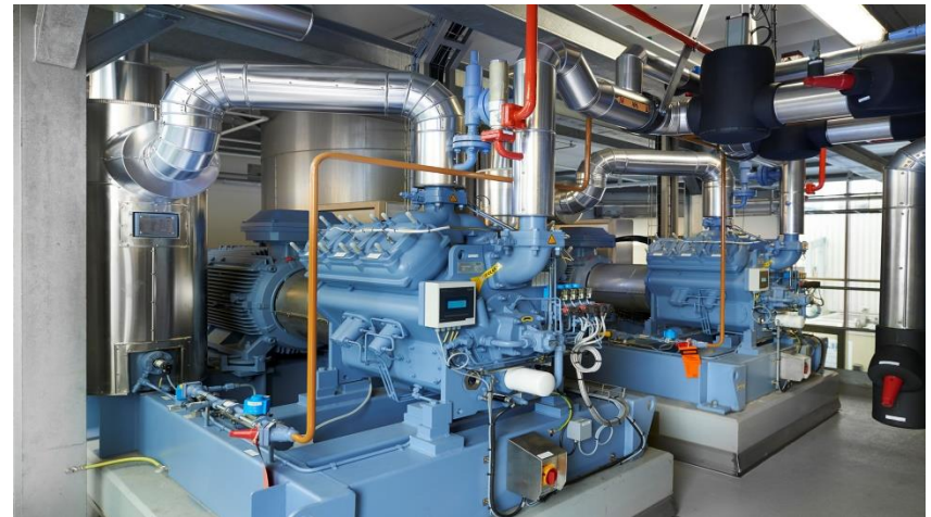
Industriële warmtepomp bij Mars
